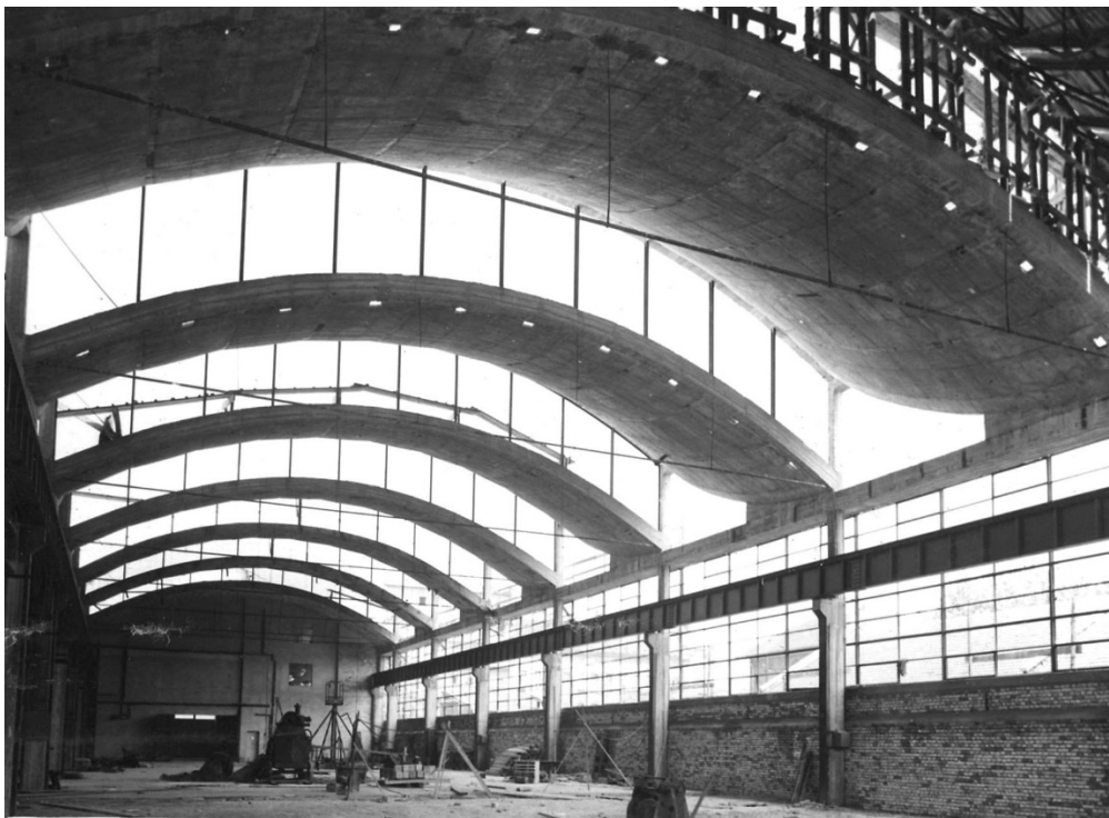
22. kép. Budapest, Ganz-MÁVA, Mozdony és Gépgyár Diesel Hajtóműgyár építése. Az egymás feletti peremgerendák között függőleges felületet képezve feszül a shed-rendszerű bevilágító. MIEA 5724
