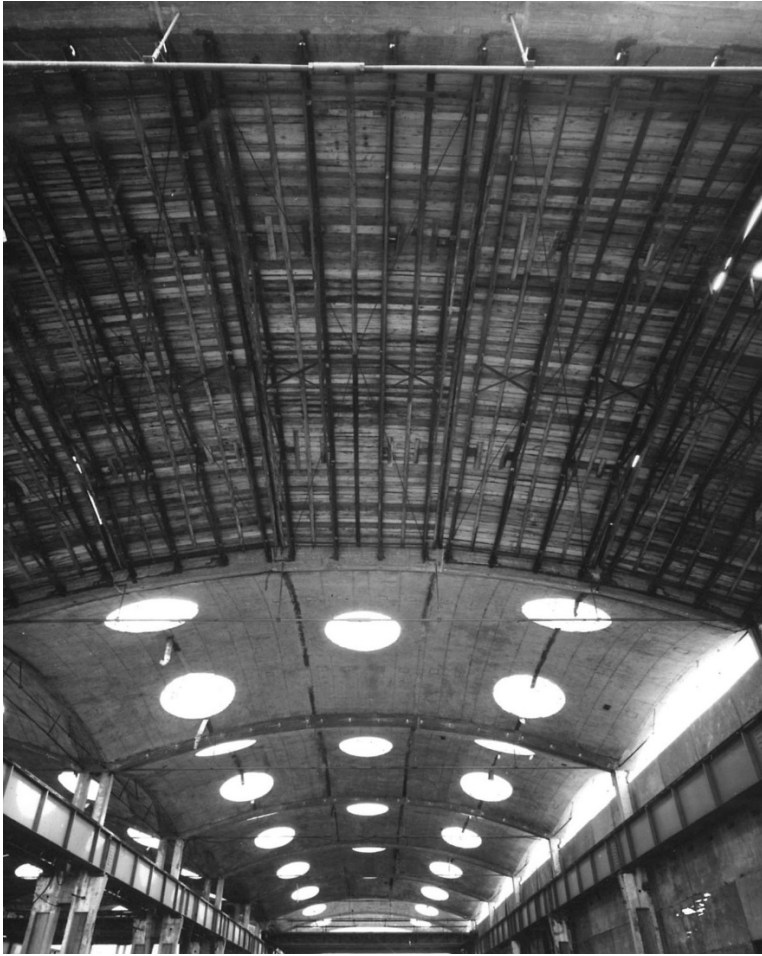
16. Csepel, Csepel Vas- és Fémművek, Szerszámgépgyár építése. Az ívek közé feszülő héjak építése. Az összefüggővé váló (hullámos) felületet lyukasztása biztosítja a csarnok bevilágítását. MIEA 8829
