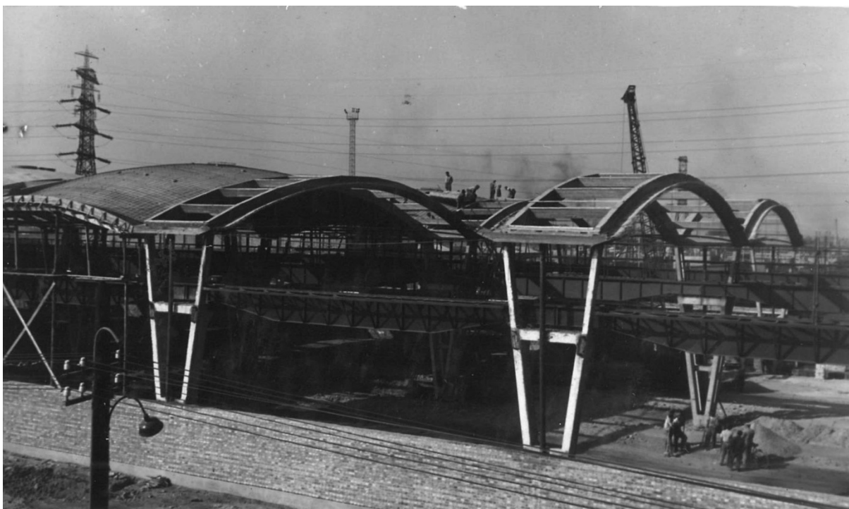
12. kép. Csepel, Csepel Vas- és Fémművek, Csőgyár üzemi csarnok építése. Külső nézet a részben elkészült fedéssel. A dupla íves tartók felső ívére készítik el a tetősíkban fekvő felülvilágító sávot. MIEA 5433
