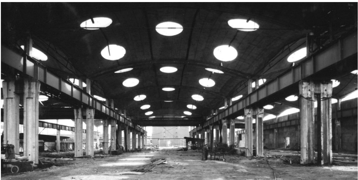
17. Csepel, Csepel Vas- és Fémművek, Szerszámgépgyár építése. Belső kép a technológiai szerelés megkezdése előtt. (a Csőgyárhoz képest finomabb munka feltétlenül igényli az egyenletes és erős mesterséges világítás kiépítését). MIEA 8834
