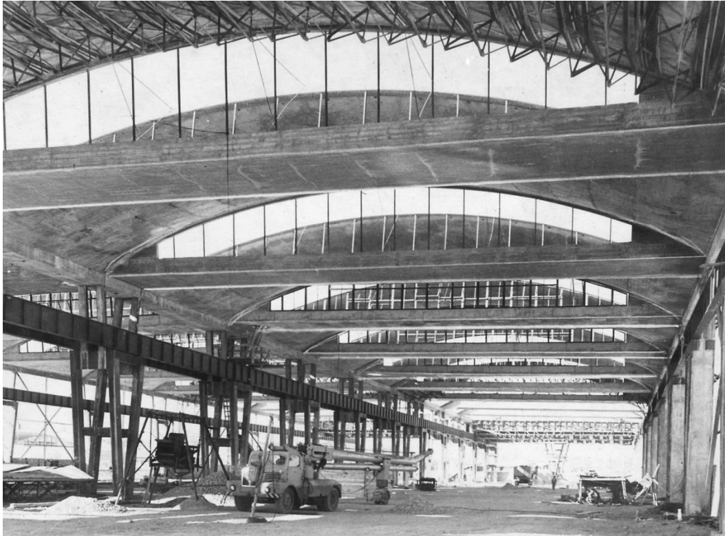
7. kép. Székesfehérvár, Könnyűfémmű Alumínium öntöde és présmű építése. Az íves tartók közé épülnek a héjak. Az utolsó mezőnél látható, hogy az elkészült íves tartókra már csak viszonylag könnyű zsaluzatot kellett építeni. MIEA 3866
